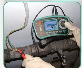
Continuity check of equipotential bonding
